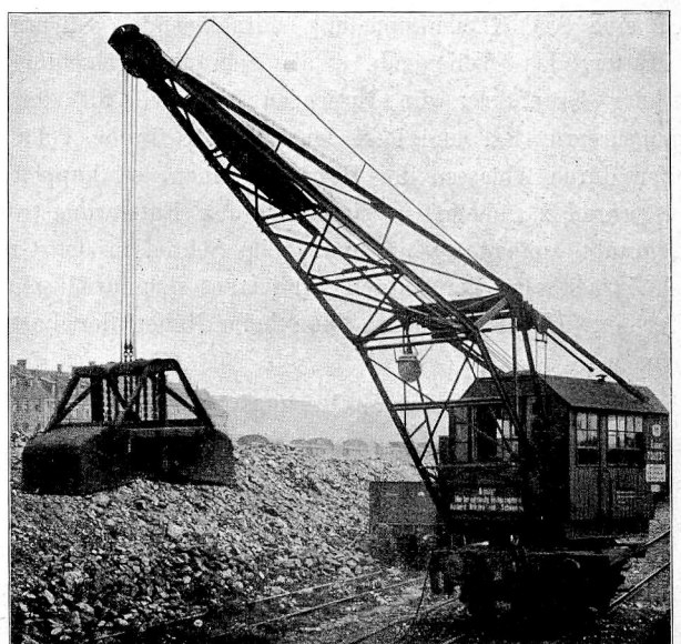
Abb. 1. Elektrisch betriebener, regelspuriger Greiferkran.
