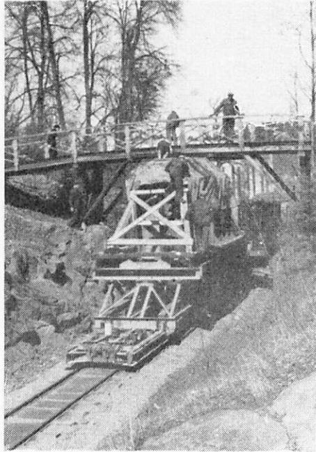
Fig. 6. En gångbro i Finspong måste justeras något.
